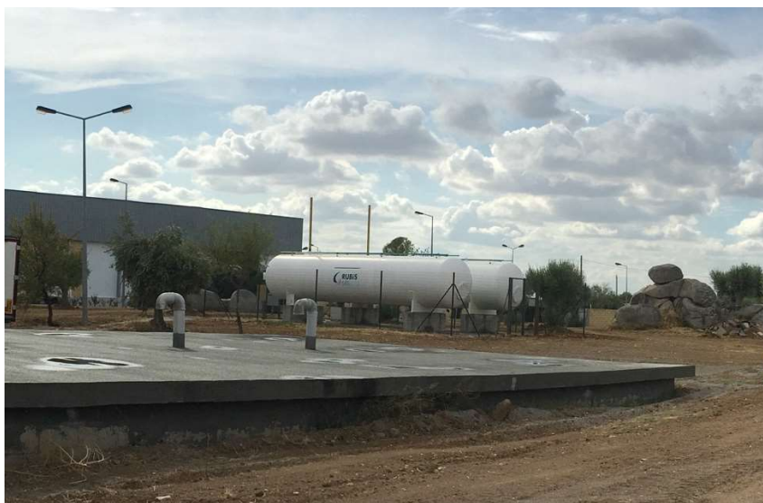
Figura 3.20 – Depósito de gás existente.
